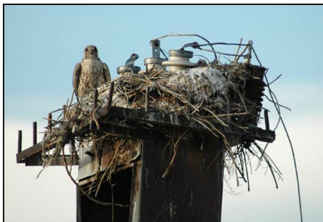
Балобан ( Falco cherrug ) на гнезде на трансформаторе в Южной Туве. 10.06.2008 г.
