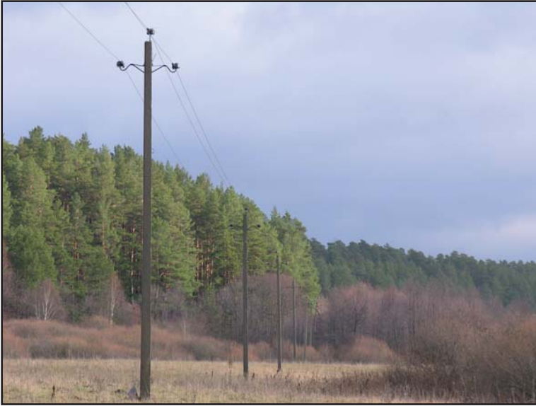
Птицеопасная ВЛ 6–10 кВ, проходящая через местообитания хищных птиц, после её оборудования птицевозащитными устройствами ПЗУ КП-1Б, стала безопасной. ФГУ НП «Смольный». Фото А. Машыны.
