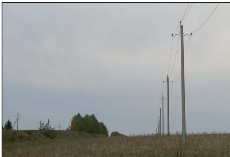
Птицеопасная линия электропередачи 6–10 кВ в Краснослободском районе. Фото К. Арянова.
