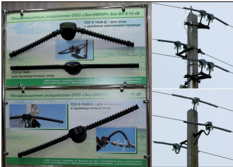
Стенд с птицезащитными устройствами, выпускаемый ООО Эко-НИОКР (слева) и эти же конструкции на ЛЭП (справа). Фото Р. Бекмансурова.
