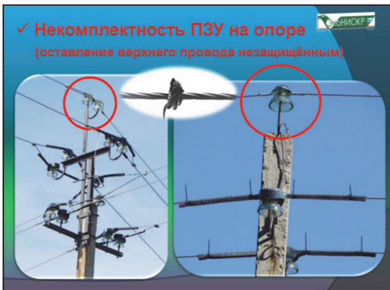
Рис. 13. Некомплектность ПЗУ на опоре.
