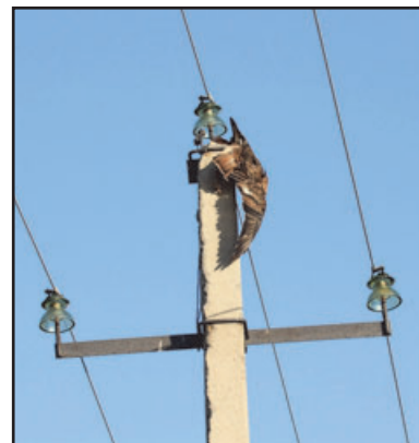
Канюк ( Buteo buteo ), погибший на ЛЭП от поражения электротоком. Фото А. Левашкина.
