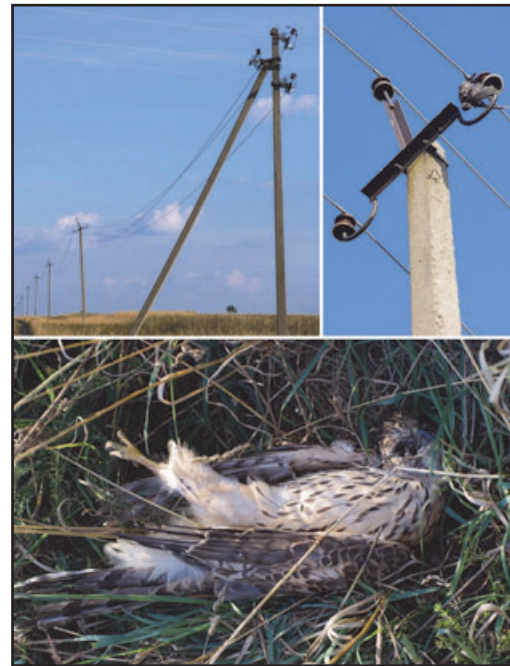
Погибшие на ЛЭП-10 кВ галка и тетеревятник. Фото В. Мельникова.
